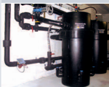
Impianto di recupero del calore alla piscina coperta di Dornbirn
